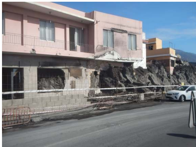
De nombreuses constructions ont été affectées, comme le logement ci-dessus qui dispose aujourd'hui de « lave à tous les étages »
